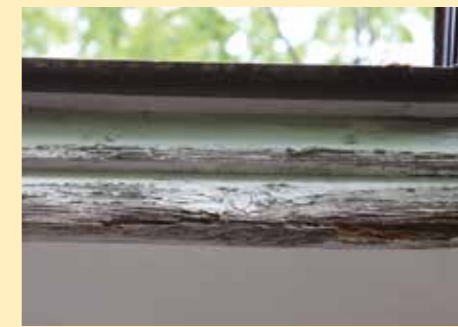
▲木製の破風。塗装をしていないので腐食が始まっています。
