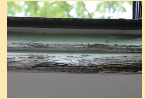
▲木製の破風。塗装をしていないので腐食が始まっています。
